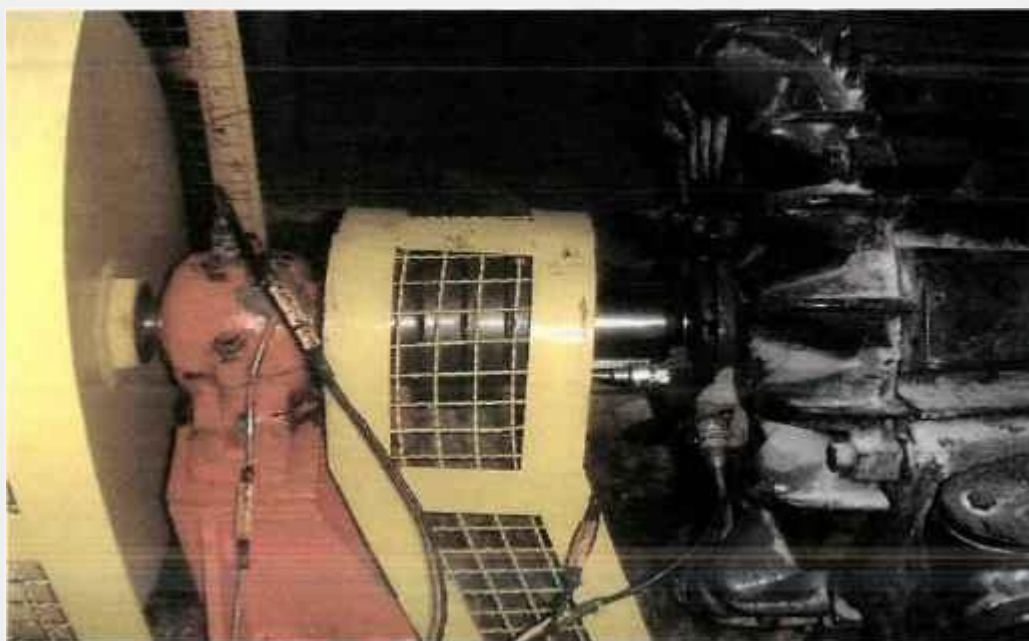
FIGURA 7. Detalhe da Bomba B-101-B: pode-se ver parte de seu volante de inércia, à esquerda, parte de seu motor, à direita, um dos seus acoplamentos, ao centro, e os acelerômetros das posições A1, A2 e A3.
