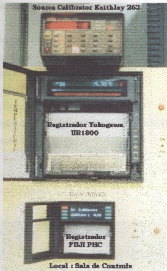
Figura 4.8 Verificação da resposta eletrônica do registrador FUJI
