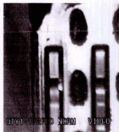
FIGURA 5.2c - EC G16 (face norte, GR2 ou GR5). Ponto de fretting por contato entre a VC A1 e a mola da grade (Tecnatom, 1997)
