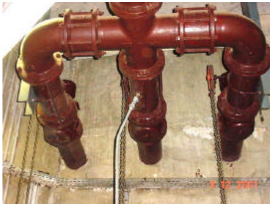
Figura 3(a): Ponto de injeção do traçador – conduto central (L.C.Helou)
