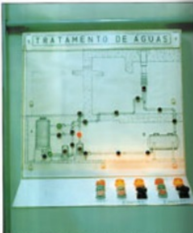
Panel de controle da planta piloto de tratamento de efluentes com acelerador industrial de elétrons
