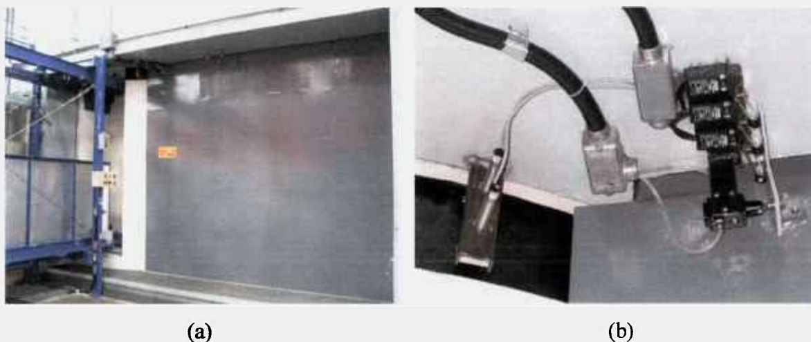
FIGURA 36 – Porta de concreto deslizante, para montagem e manutenção da instalação e do sistema de transporte dos produtos: (a) acoplamento perfeita na porta giratória e (b) detalhe dos três microswitches elétricos e uma válvula pneumática, do sistema de segurança e intertravamento.
