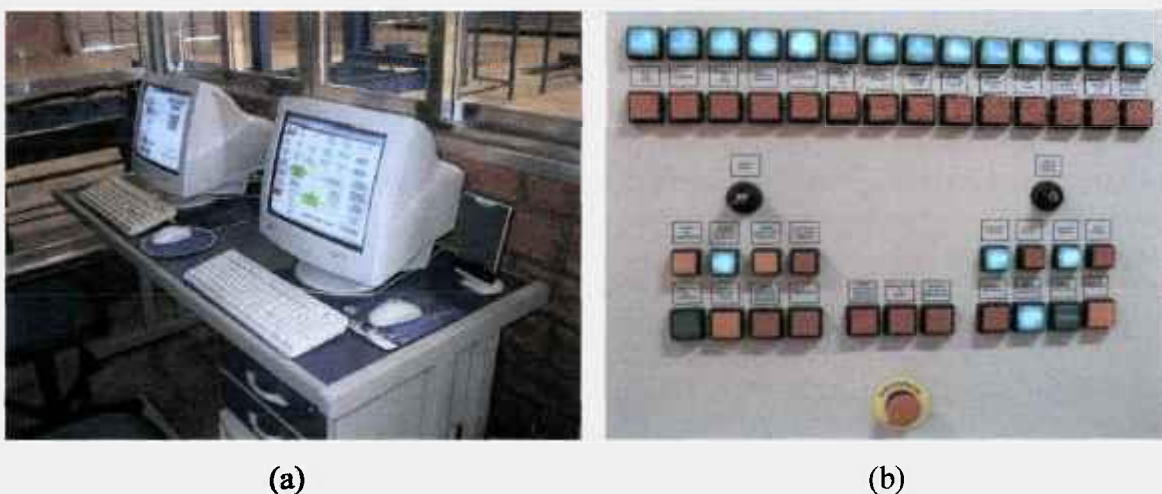
FIGURA 37 – Sistemas de controle de processo (transporte), segurança e intertravamento, do irradiador multipropósito: (a) microcomputadores instalados na sala de controle, responsáveis pelo acompanhamento dos sistemas e (b) painel eletro-eletrônico do sistema de segurança e intertravamento (lógica de relês).
