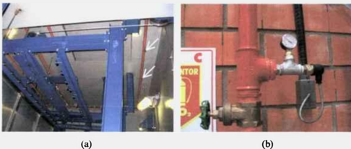
FIGURA 33 – Sistema de combate a incêndio tipo dilúvio, instalado na câmara de irradiação, do irradiador multipropósito: (a) sprinklers tipo spray e (b) manômetro e sensor eletrônico de pressão d'água na tubulação.
