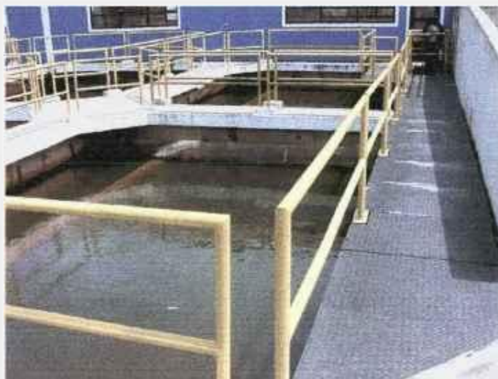
FIGURA 10 - Estação 3: Filtro da ETA Rio Grande, São Bernardo do Campo, SP.
