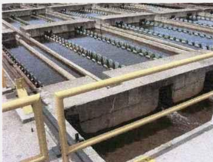
FIGURA 9 - Estação 2: Decantador da ETA Rio Grande, São Bernardo do Campo, SP.
