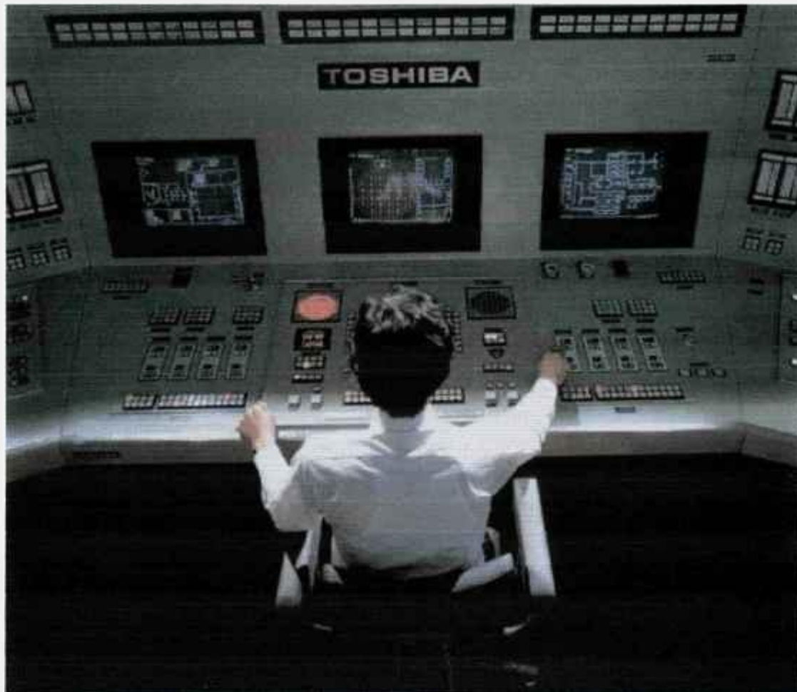
Figura 4 - Sala de controle do tipo PODIA, desenvolvida pela Toshiba para reatores do tipo BWR do Japão. [32]
