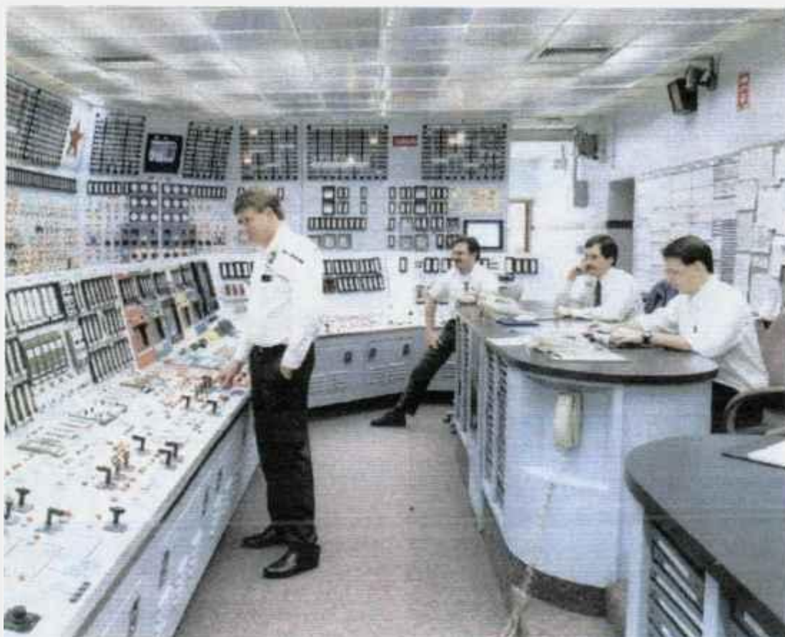
Figura 1 - Sala de controle convencional de uma central nuclear com reator do tipo PWR. [12]
