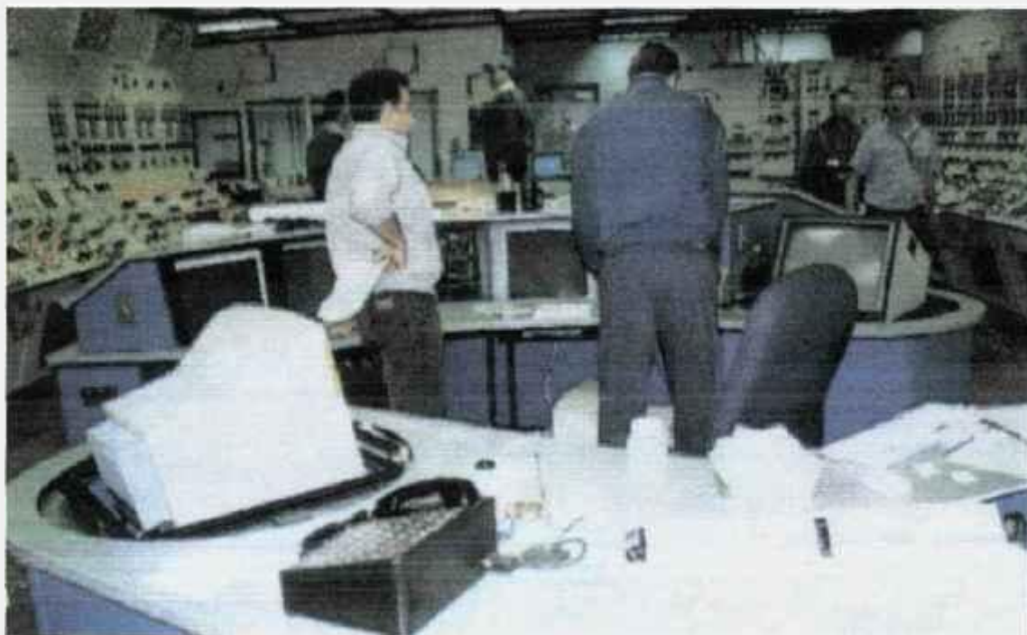
Figura 3 - Sala de controle de segunda geração para reatores do tipo PWR. [13]
