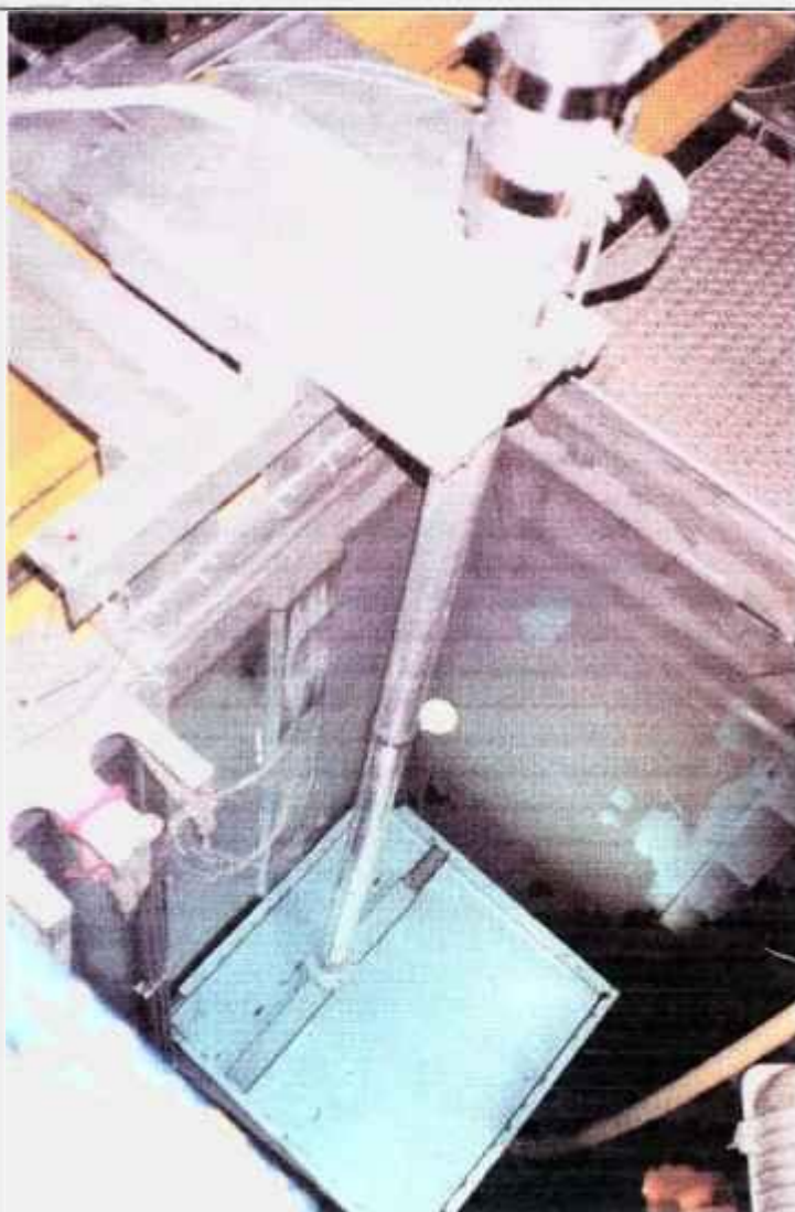
Figura 9 - Fotografia do sistema para espectrometria gama instalado na piscina de estocagem do reator IEA-R1, mostrando em detalhe um elemento combustível posicionado para medida no ponto 3 (central).
