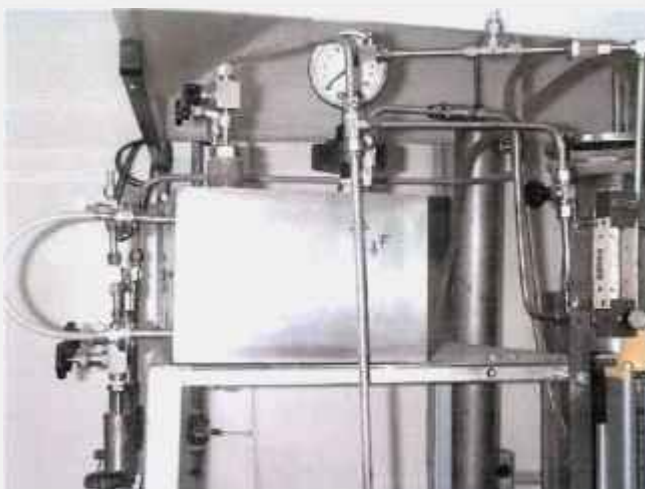
Figura 4.36 - Sistema pressurizado para alimentação do resíduo no reator.
