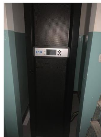
Fonte de alimentação Ininterrupta (UPS)
