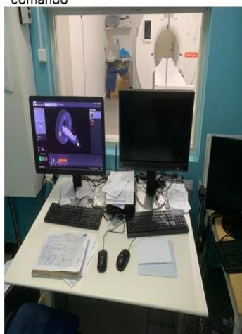
Subsistema operacional na sala de comando
