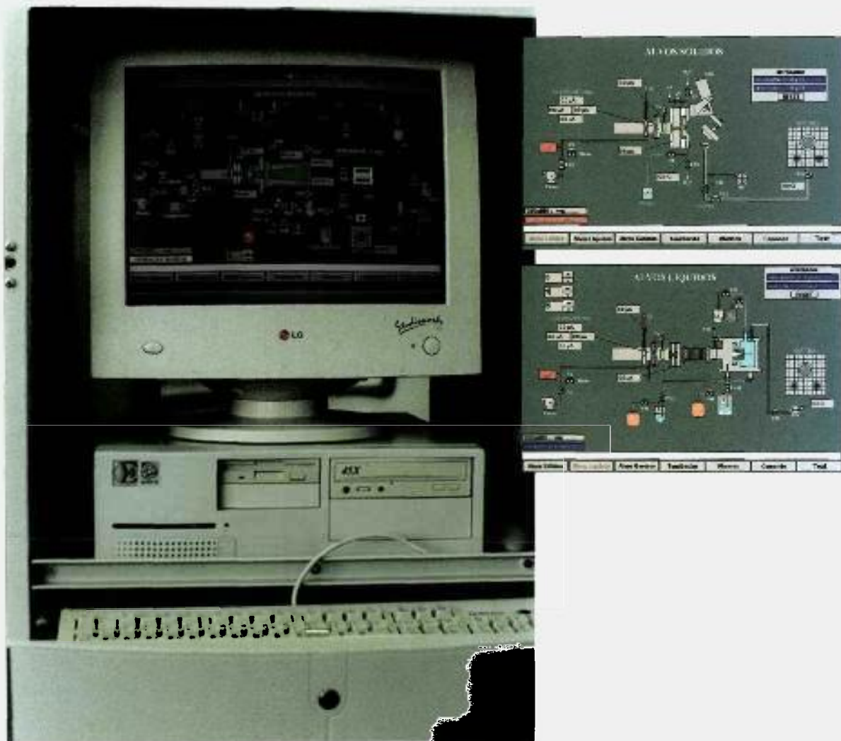
Figura 4.18: Apresentação do sistema já desenvolvido e implementado com o microcomputador instalado no Painel de Controle, especialmente projetado para esta aplicação.
