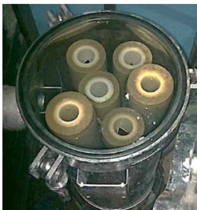
Figura 3: conjunto de seis filtros do sistema de retratamento do reator IEA-R1.
